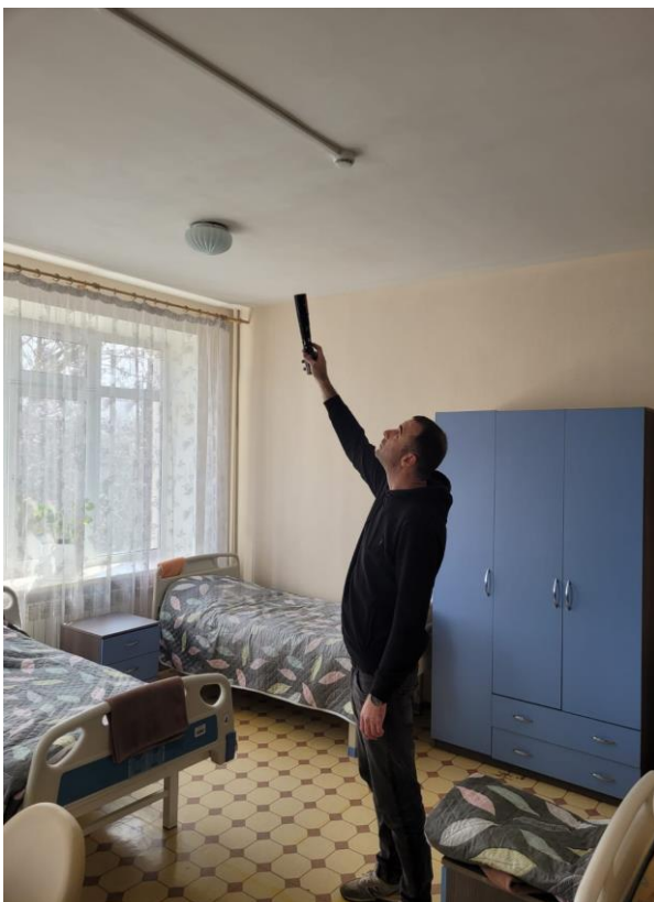
Сработка пожарных извещателей при участии обслуживающей организации
